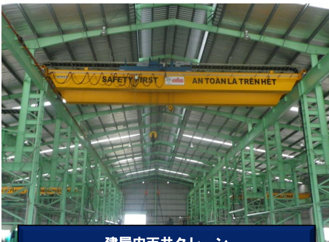
建屋内天井クレーン Indoor Overhead Crane
