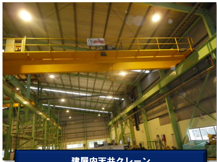
建屋内天井クレーン Indoor Overhead Crane
